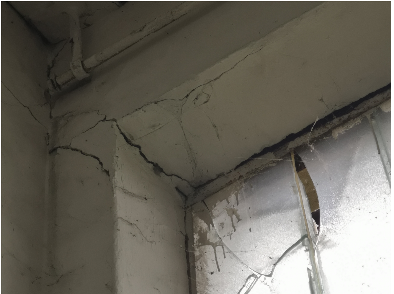
(pukotina na spoju grede i serklaža na mjestu zabatnog zida)
