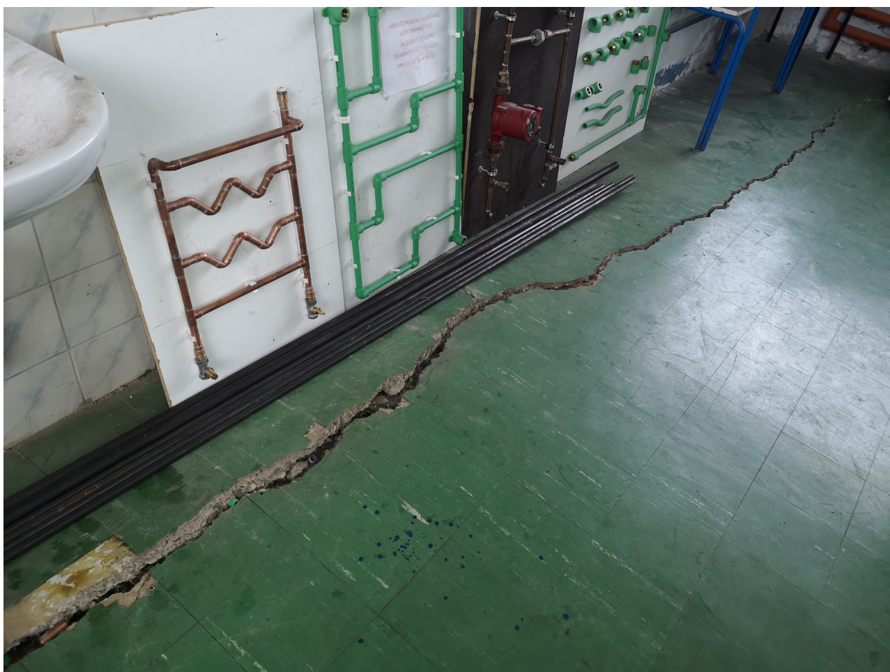
(pukotina u podnoj ploči)
