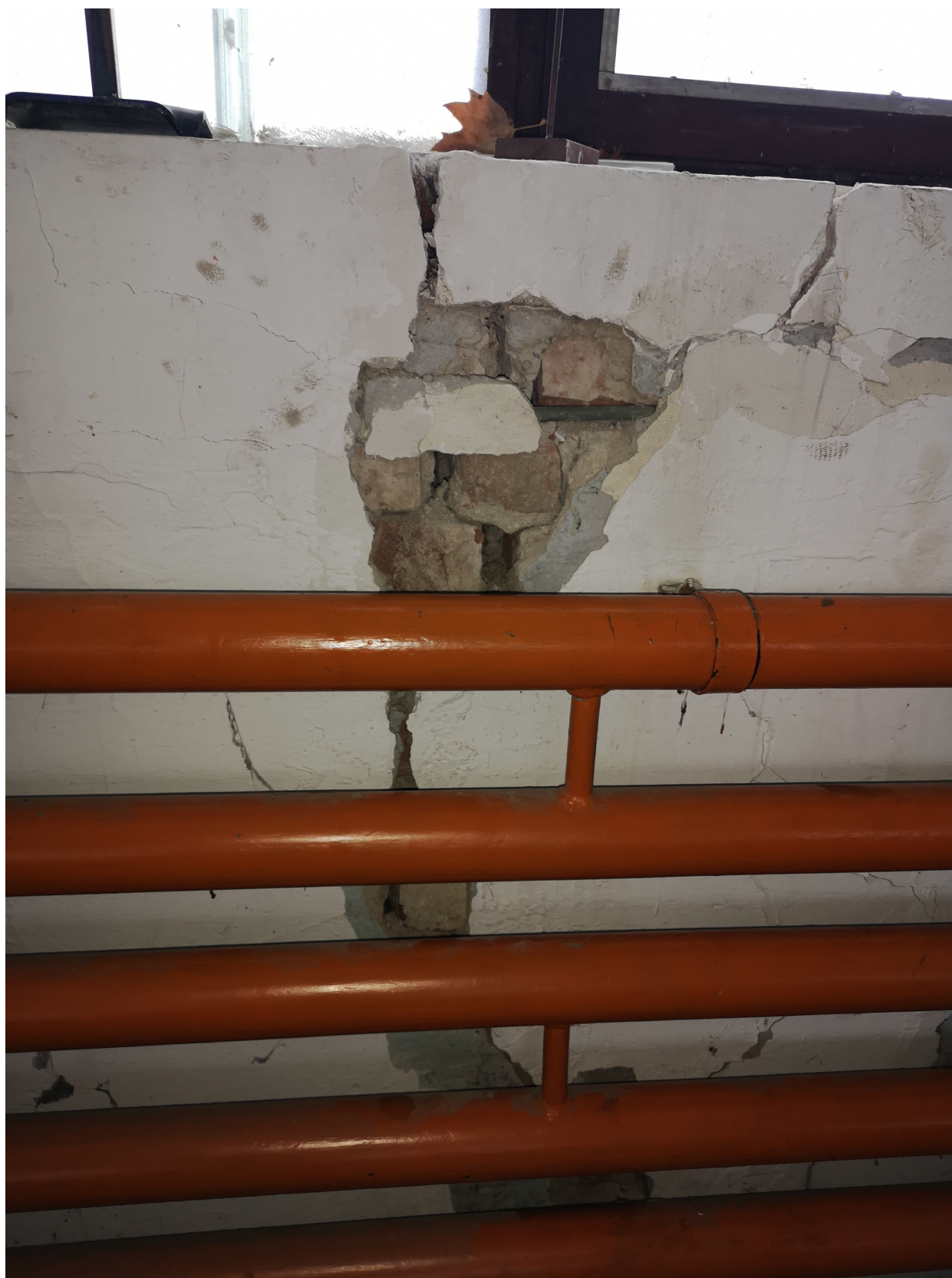
(vertikalna pukotina u zidu s unutarnje strane)
