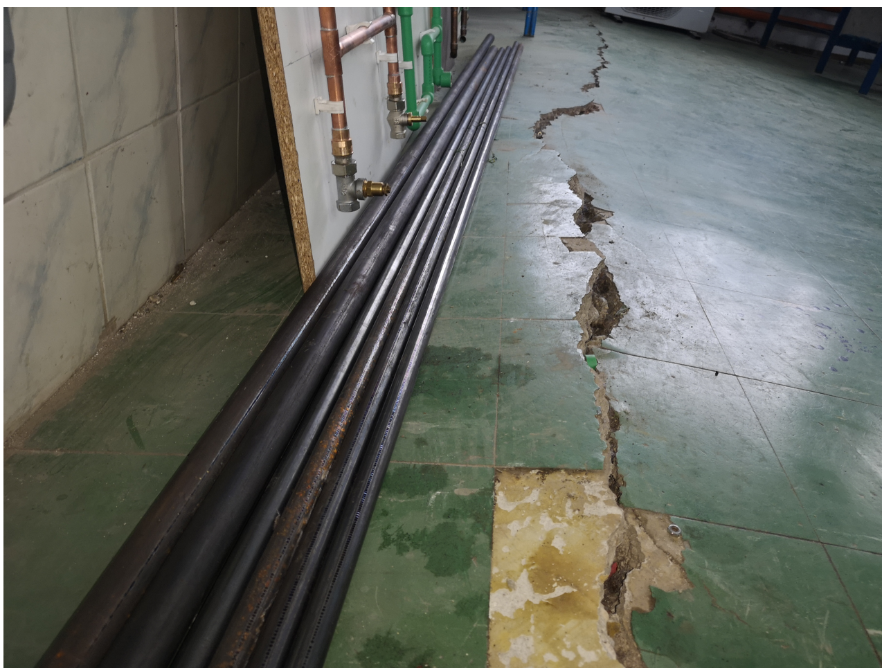
(pukotina u podnoj ploči)
