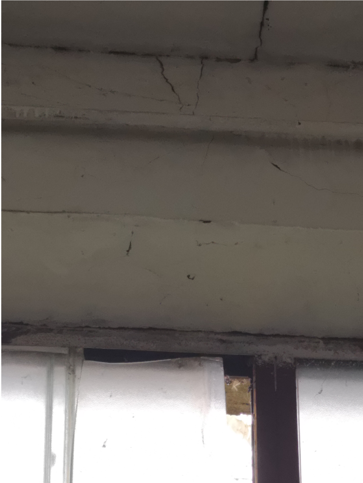
(vertikalna pukotina u gredi)
