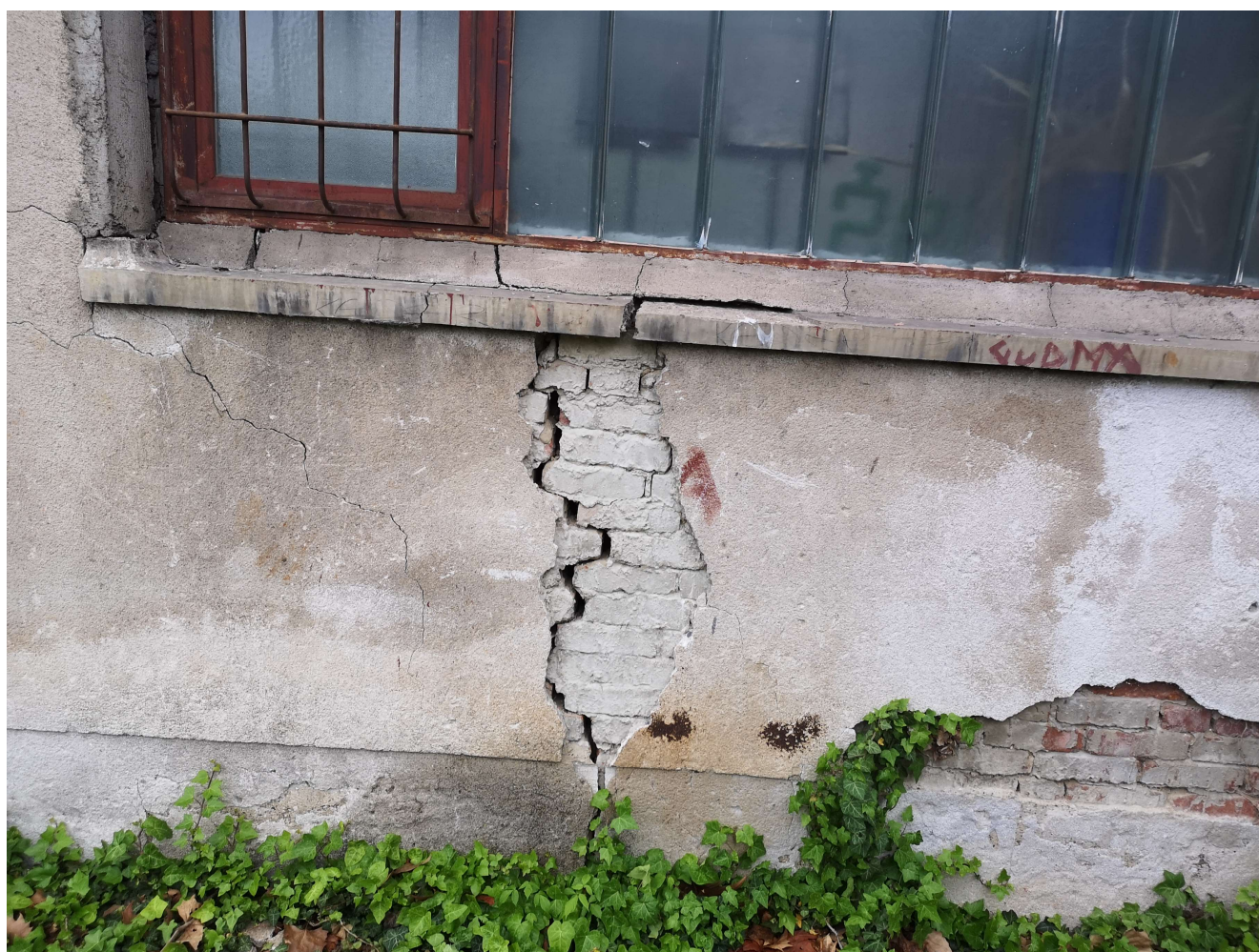
(vertikalna pukotina u zidu s vanjske strane)
