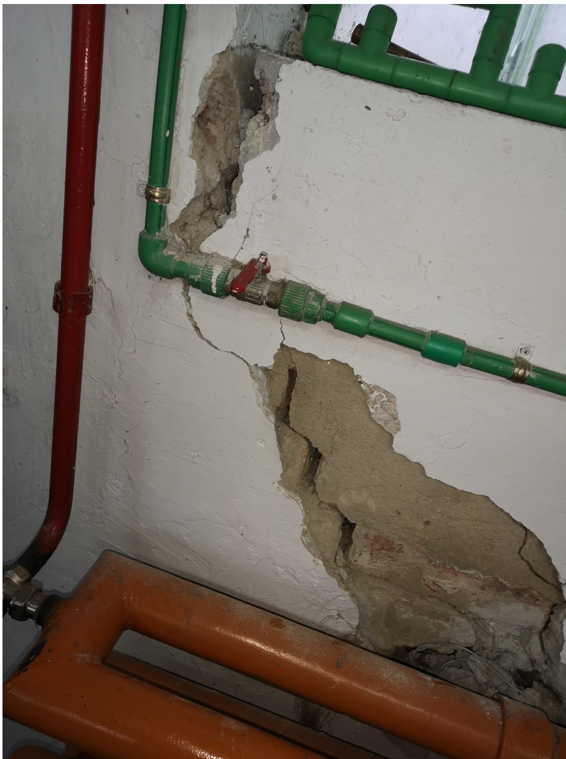
(vertikalna pukotina u zidu s unutarnje strane)
